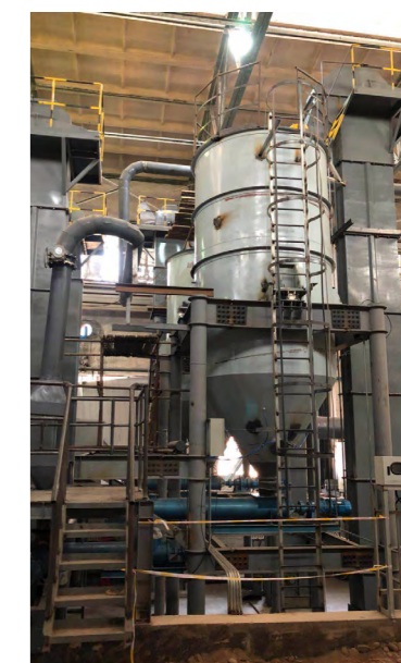
第二条超万吨大修渣无害化生产线在兰州分公司建成投运
